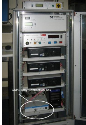
19“-Rack im Mess- und Registrierraum
